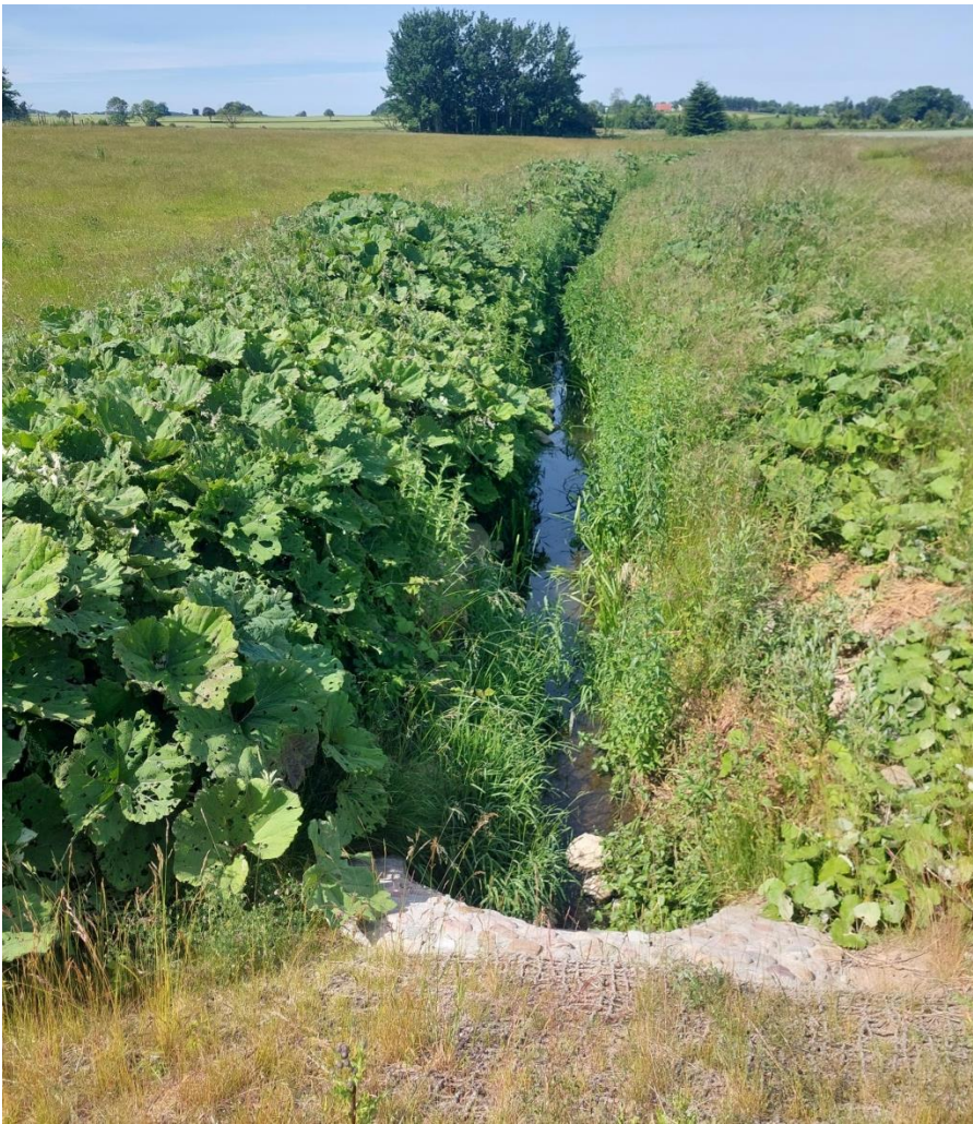
Figur 33. Øster Egeborg vandløbet. Her ses tydelig kanalisering, dybt nedstik, mulighed for dårlig vandføring grundet stor mængde grøde og fremspring i vandløbet.
